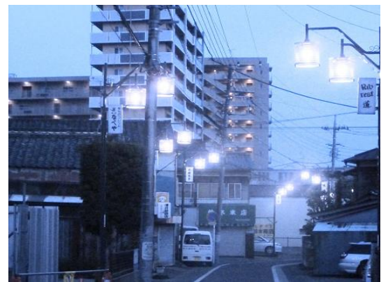
LED照明を使った街路灯1灯80W⇒18Wへ
