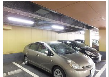
駐車場通路 LED ダウンライト
