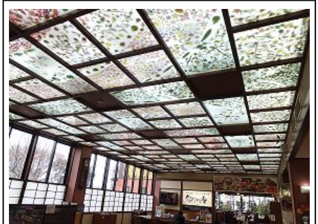
大広間天井 LED 直管埋込
