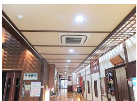
各設備への通路 LED ダウンライト
