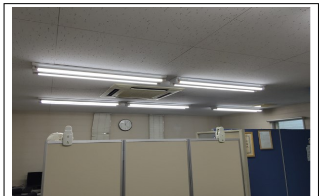
事務所 LED交換後
