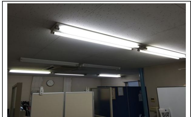
事務所 従前照明
